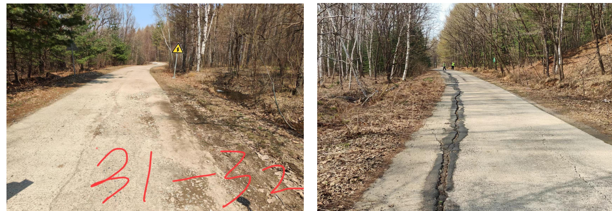
路面坑槽、裂缝
