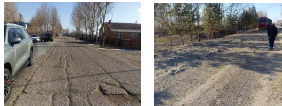
道路破碎及翻浆病害
